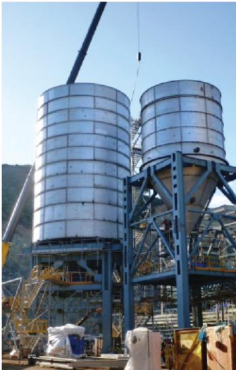
FLY ASH SILO
